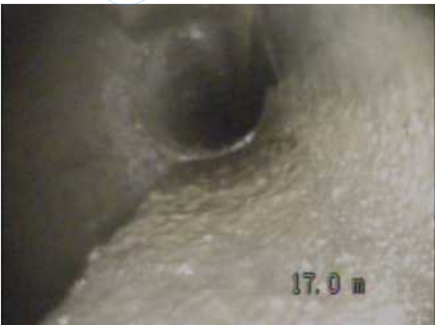
103号室専有庭内汚水枡
