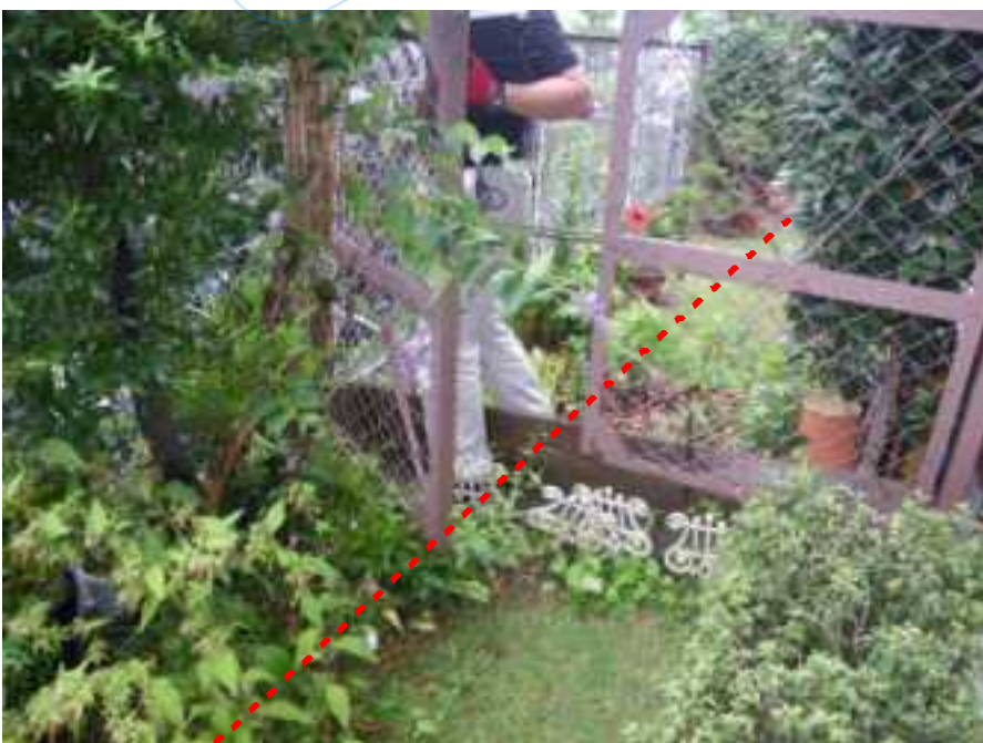
点線部勾配不良の埋設管
