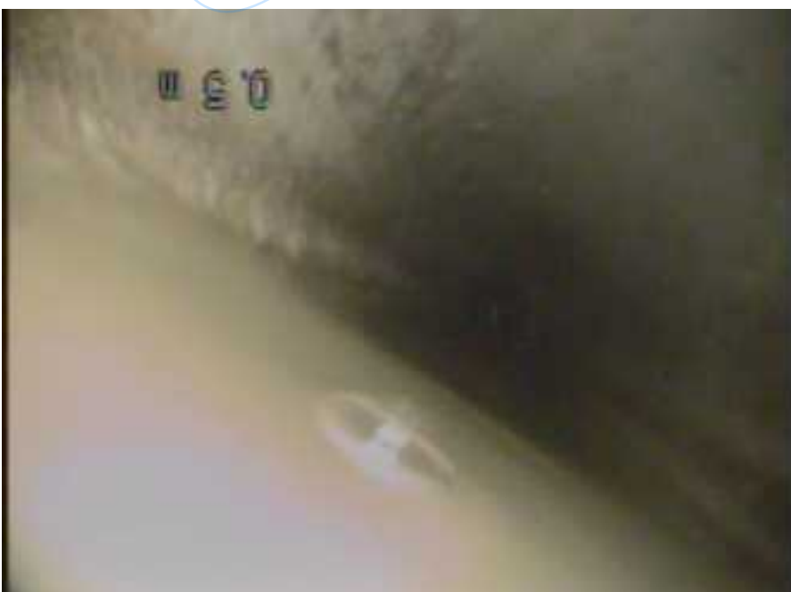
勾配不良により汚水滞留
