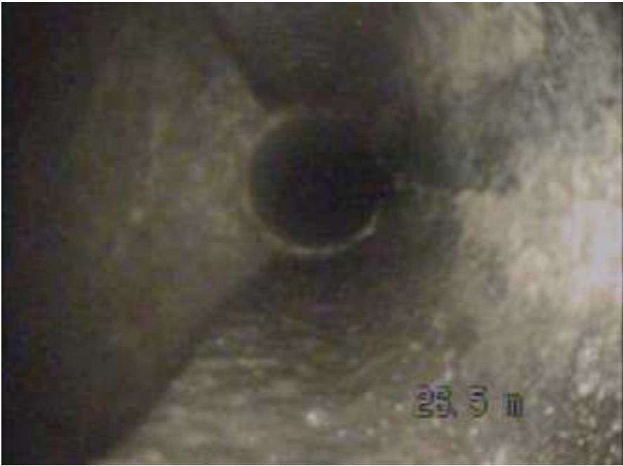
104号室専有庭内汚水枳
