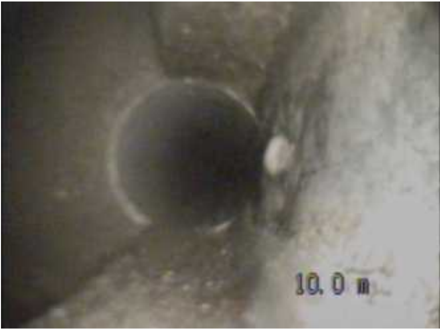
102号室専有庭内汚水枡
