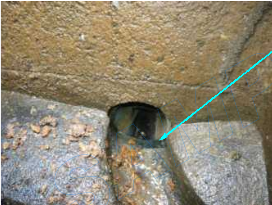
104号室汚水枡内 建物側塩ビ配管と枡インバート 間に隙間あり
